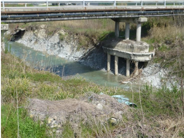
Fig.26. 27.3.2016, ponte di V. Serrabella; il pericolo per la stabilità del ponte risulta evidente: si noti l'erosione e incisione dell'alveo
