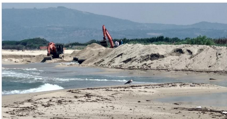
Fig. 14a Fiume Mesima 24.09.2019 - Ogni anno viene sbarrata la foce con la costruzione di uno sbarramento (con carattere di emergenza) da parte delle amministrazioni comunali interessate, sbancando le dune e danneggiando il delicato habitat naturale.
