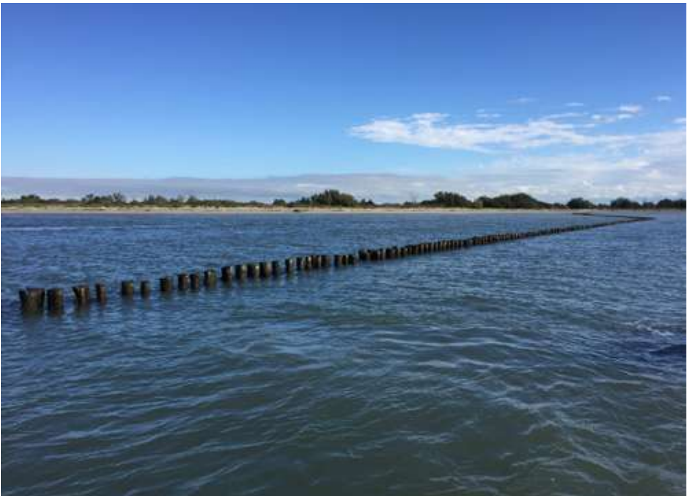
FIGURA 192 Scanno di Goro: 2 dei pennelli in pali di legno realizzati lungo lo scanno di Goro (in alto foto maggio 2017, in basso foto ottobre 2016).
