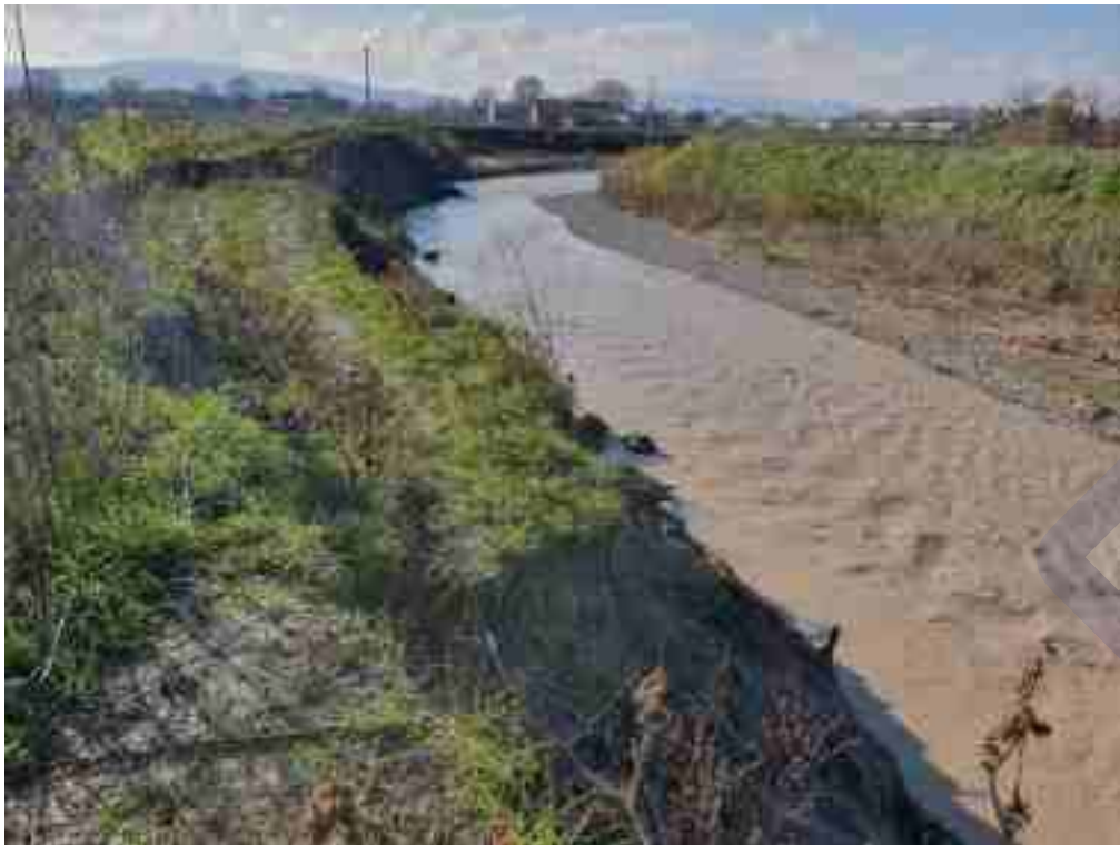
Fotografia del tratto in erosione e scosceso, visto da valle, il 3 dicembre 2019
